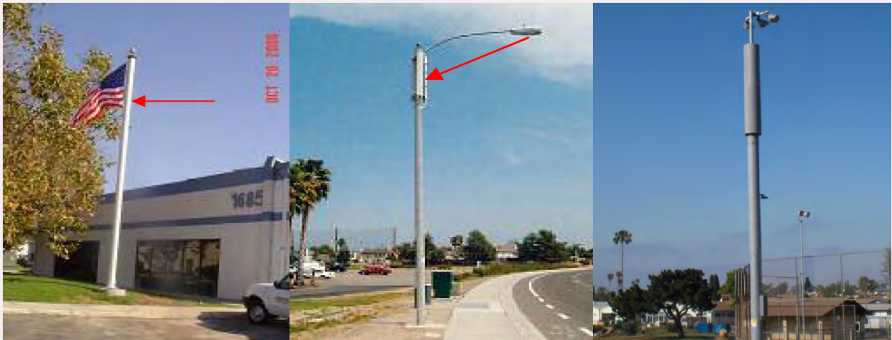
Fig. 85 - Collocazione in elementi di arredo urbano: le antenne, di piccole dimensioni come le microcelle, possono essere efficacemente incorporate nelle aste delle bandiere, in elementi scultorei, negli arredi urbani, nei lampioni o nei segnali stradali.
