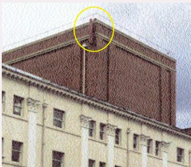
Fig. 78 - Installazioni in facciata: nel caso di installazioni in facciata i dispositivi dovranno fondersi visivamente con le facciate su cui sono applicati attraverso l'utilizzo di antenne dello stesso colore del supporto, garantendo la non visibilità dalla strada dei cavi coassiali, riprendendo le linee dell'edificio.
