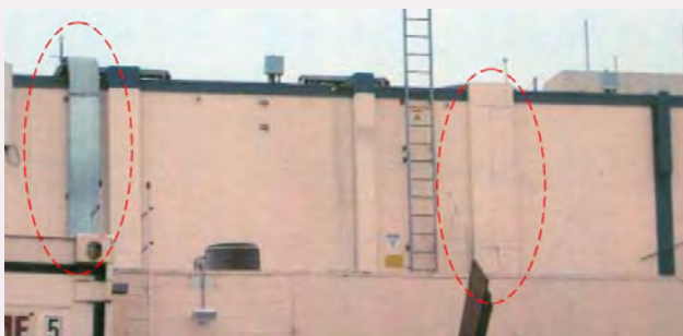
Fig. 87 - Alloggiamento dei cavi: l'immagine mostra una modalità non appropriata di realizzare il passaggio dei cavi
