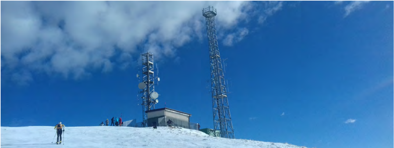
Fig. 1 - Progetto di paesaggio: antenne e ripetitori sul Monte Pora (Bergamo). Quale luogo di frequentazione di sciatori ed escursionisti che da questo punto godono di un vasto panorama sulla Val Camonica, il sito richiede un'attenta progettazione paesaggistica di tutti gli elementi del sistema: antenne, parabole, locali tecnici, recinzioni, strade di accesso. (foto: Gaia Pozzi)
