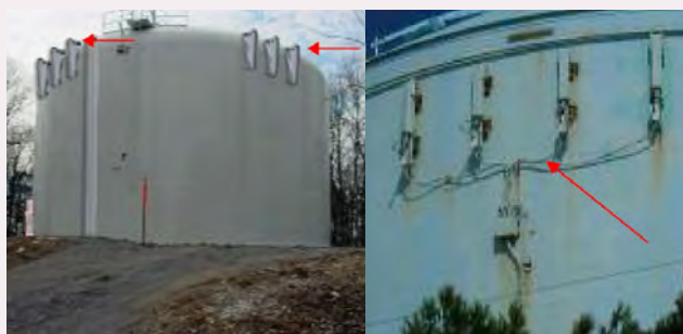
Fig. 81 - Installazioni su torri dell'acqua: anche quando il supporto per le installazioni di telecomunicazione è rappresentato da elementi di per sé già "tecnologici" la disposizione e le modalità di installazione devono essere tali da garantire ordine e sobrietà di percezione. È opportuno, ad esempio, prevedere nella loro disposizione schemi simmetrici rispettosi delle forme del supporto (a sinistra) ed evitare l'eccessiva visibilità dei cavi e degli elementi accessori (a destra).
