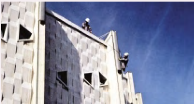
Fig. 63 - Installazioni in facciata: è essenziale l'integrazione dei nuovi elementi con il supporto su cui sono collocate. L'immagine mostra l'installazione di antenne il cui posizionamento riprende le linee verticali dell'edificio e dove forma, dimensione e colore sono coerenti con quelli del supporto.
